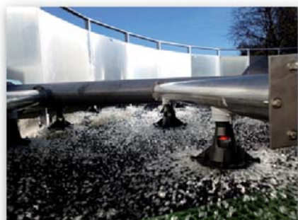
Distribution des effluents
